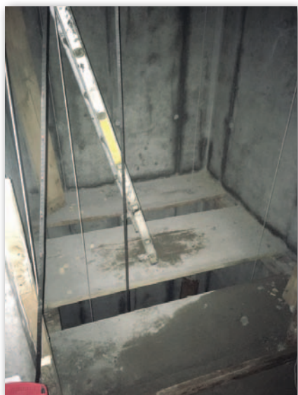
Fot. 6. Opuszczona ruletka w szybie
