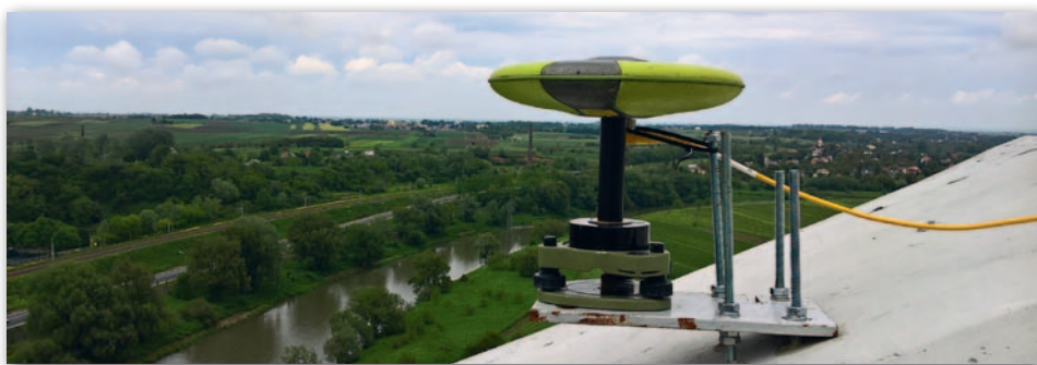
Fot. 1. Antena GNSS zamontowana na pylonie północnym mostu
