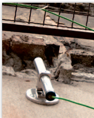
Inklinometr na fasadzie praskiej kamienicy
