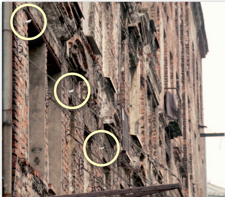
Rząd pryzmatów na kamienicy przy ul. Targowej
