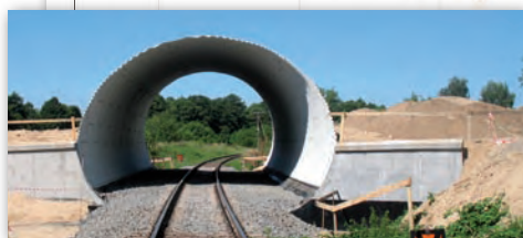
Raport graficzny z pomiaru skrajni (przepust kolejowy na linii Koszalin - Goleniów)
