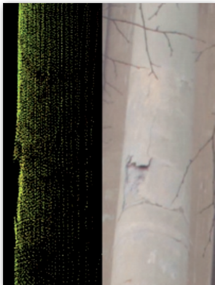
Rys. 2. Widok uszkodzenia kolumny (skan i zdjęcie)
