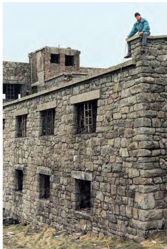
Ściany (murowane z kamienia) są w zaskakująco dobrym stanie
