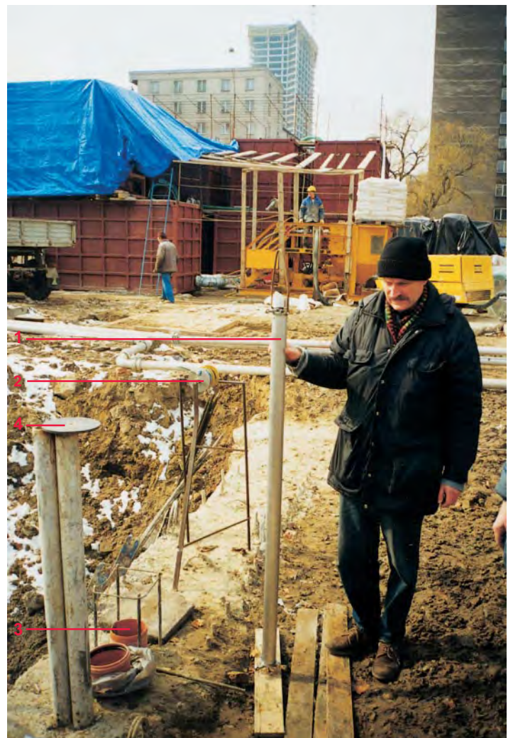
Rys. 3. Inklinometr (1), blok (2) służący do opuszczania inklinometru do rury, wylot rury inklinometru (3) zastabilizowanej w ścianie szczelinowej oraz stanowisko tachimetru elektronicznego (4)
