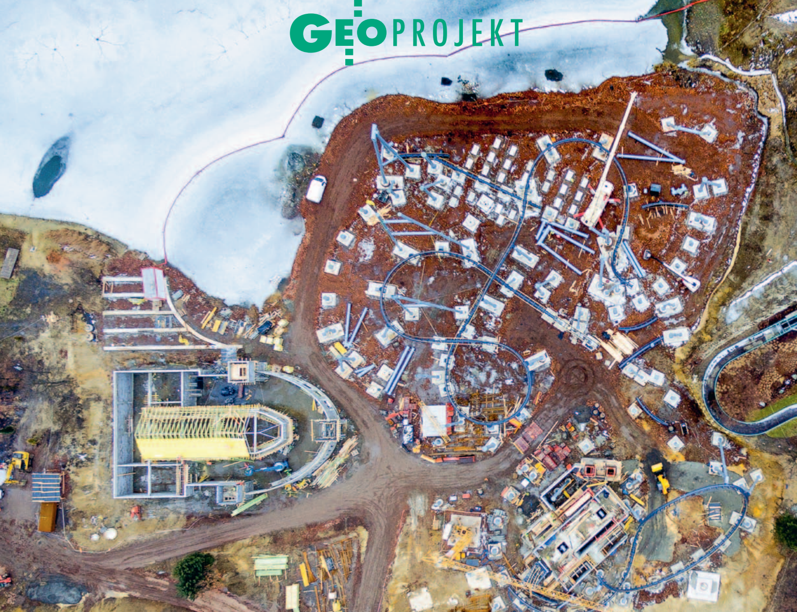
Fragment Śląskiego Wesołego Miasteczka w lutym 2017 r. W centrum – plac budowy Lech Coastera, po prawej – gotowa Diamond River
