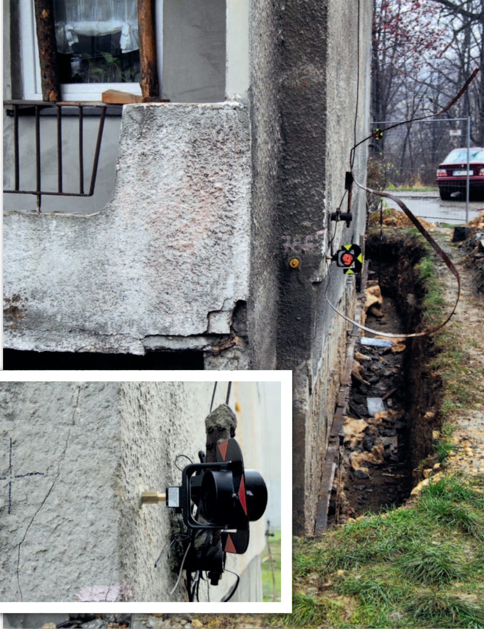
Rys. 2. Sygnał pomiarowy zamontowany na punkcie kontrolowanym
