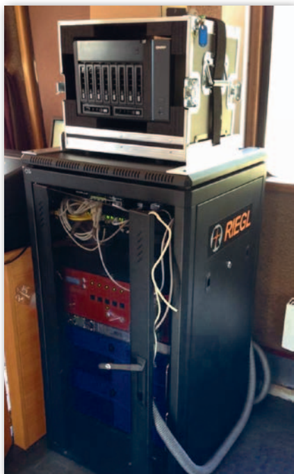
Rys. 2. Wnętrze dreżyny z zainstalowanymi urządzeniami do integracji i przechowywania danych (macierze dyskowe pozwalające na zrzut danych z systemu pomiarowego)
