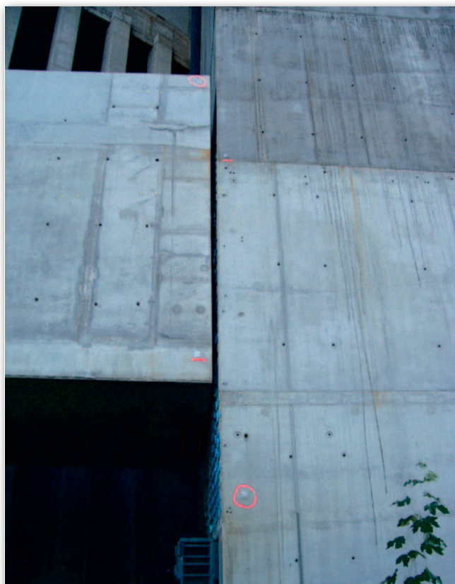
Początek drogi. Z prawej i lewej strony identyczne szczeliny między mostem i pylonami. Minimalne podniesienie mostu na siłownikach tylko z jednej strony groziło natychmiastowym sklinowaniem
