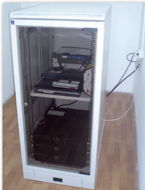
Szafa RACK z odbiornikiem stacji referencyjnej
